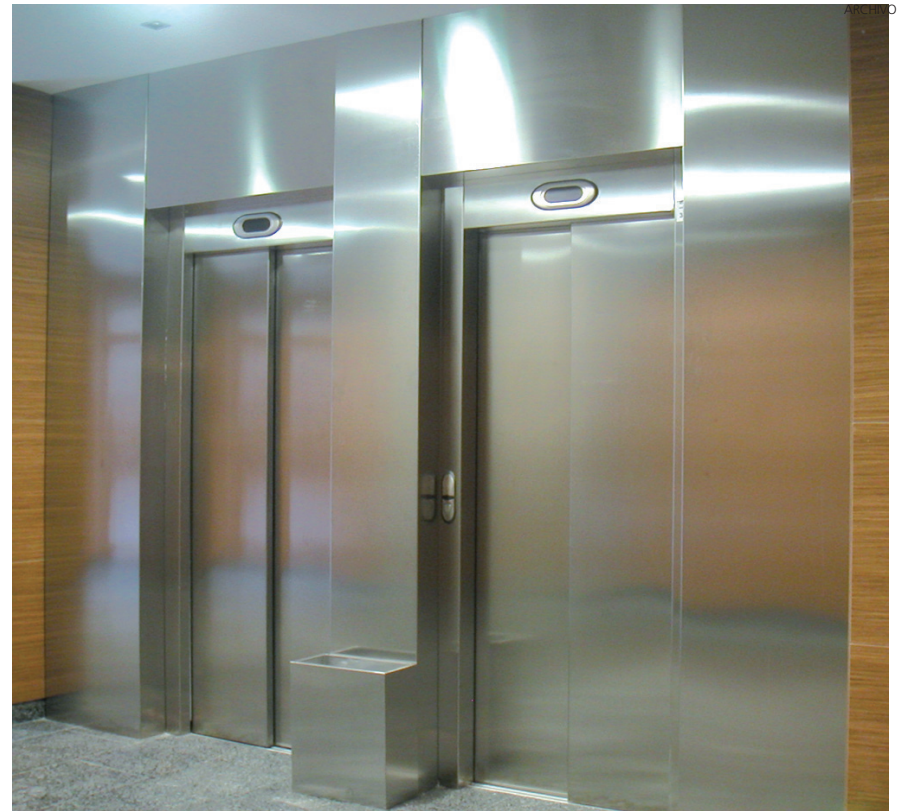
El mercado de ascensores carece de la suficiente competencia.
