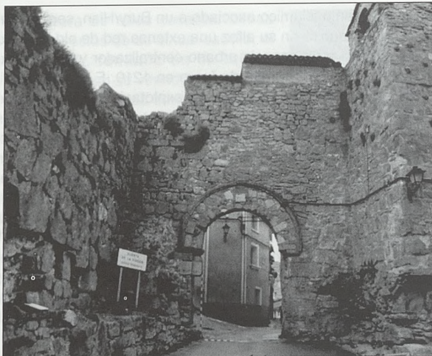
Puerta de la Virgen, vista general en 2002, previa a la restauración parcial actual
