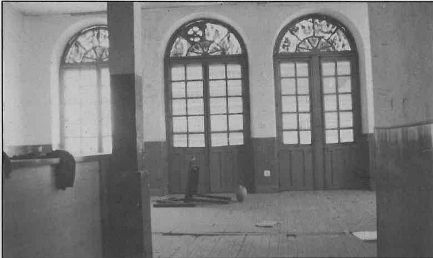
El edificio presenta un avanzado estado de deterioro.
