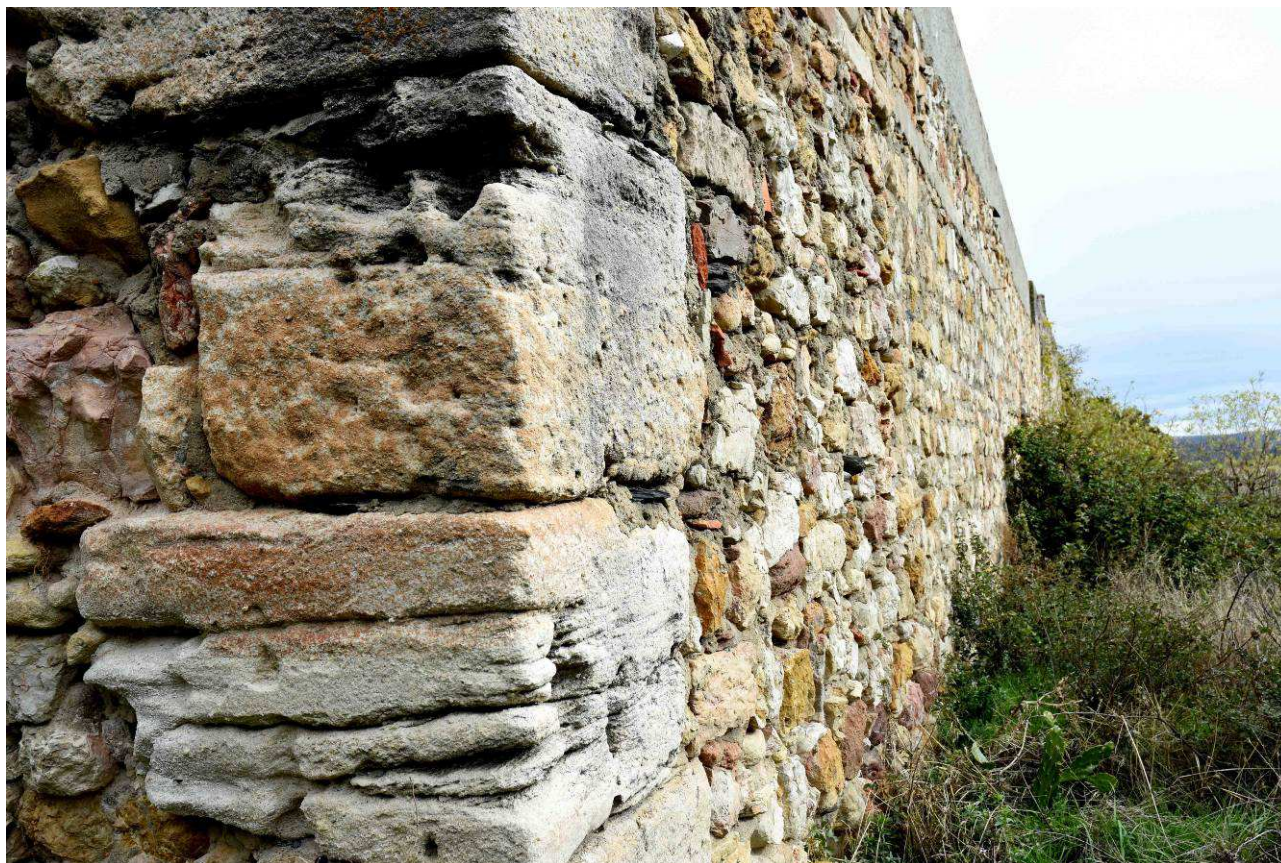
Elementos constructivos muy deteriorados
