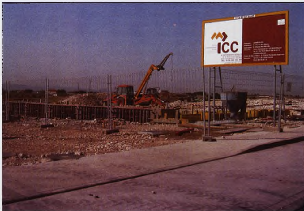
Imagen del estado de las obras del futuro Conjunto Industrial del Polígono "Daimiel Sur"
