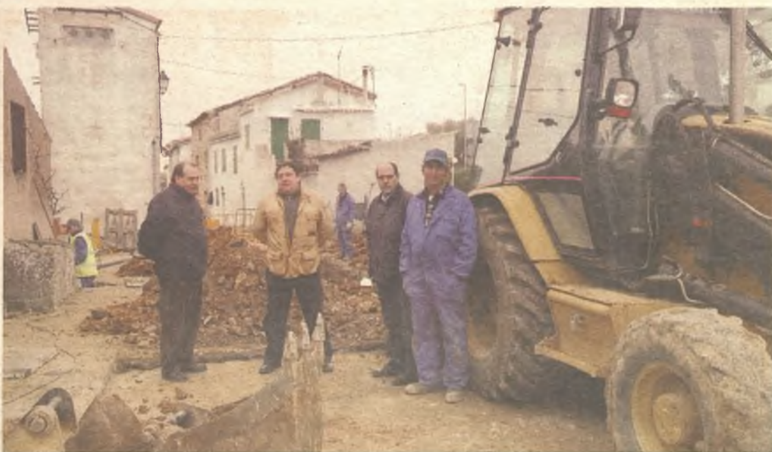
La red de abastecimiento y saneamiento de La Toba ha recibido una inversión de 43.000 euros.
