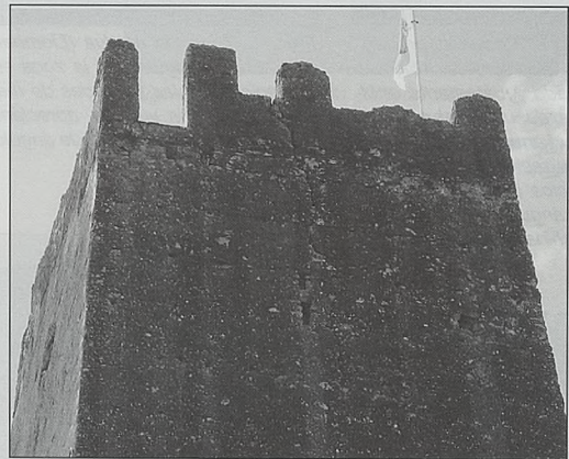
Fig. 29. Torre de Serra. Vista del lado norte con los mechinales y vigas de los suelos de los dispositivos ligeros de ángulo y, a la izquierda, el vano de acceso a la buharda del ángulo noreste
