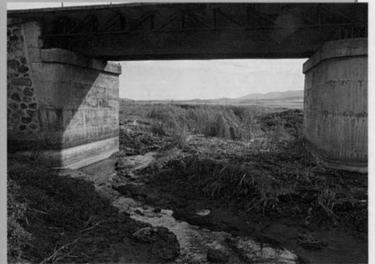
Tres vistas del Ojailén junto al puente de la carretera de Puertollano a Mestanza, donde puede apreciarse el deterioro actual del río.
