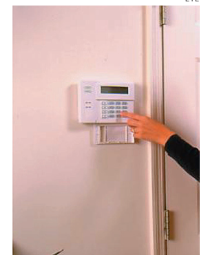
Alarma situada en un edificio.
