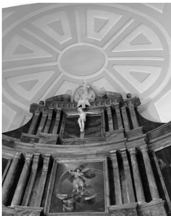
Estado actual de la parte superior del Retablo central de la I. Parroquial.
