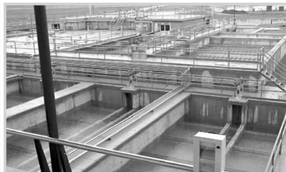
Estación de Tratamiento de Agua.
