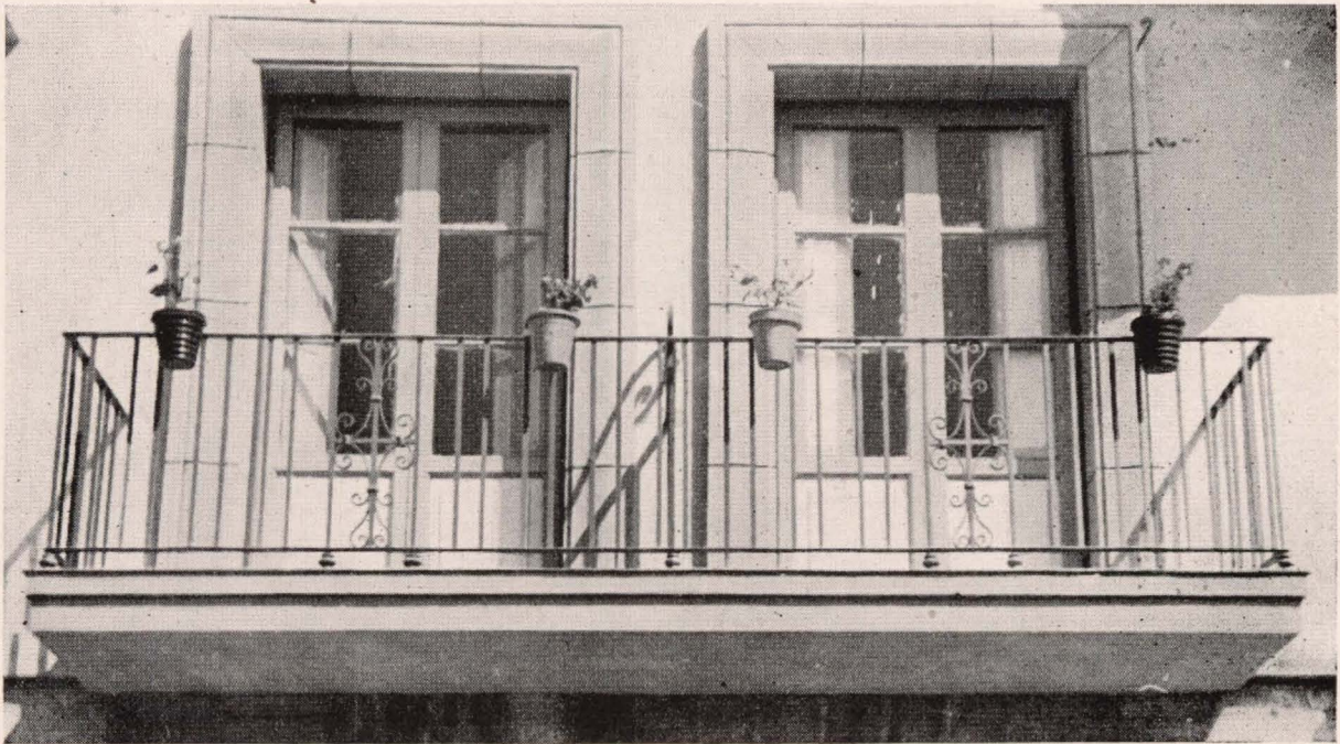
OVIEDO.—Viviendas de San Lázaro. Detalles de hierros. Balcón.
