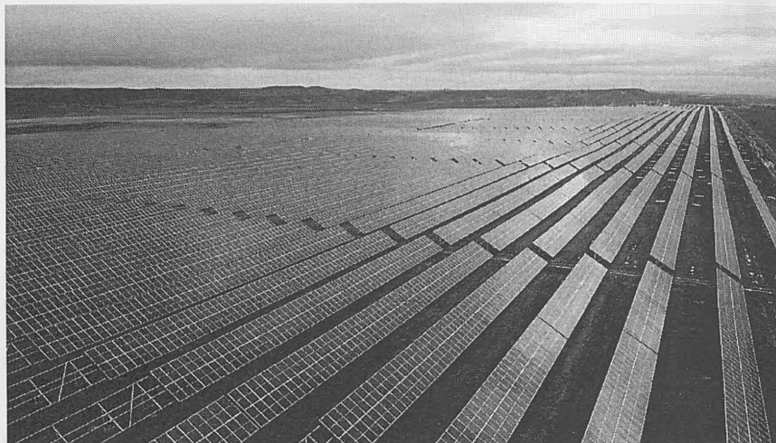
Planta fotovoltaica Carpio De Tajo en Toledo
