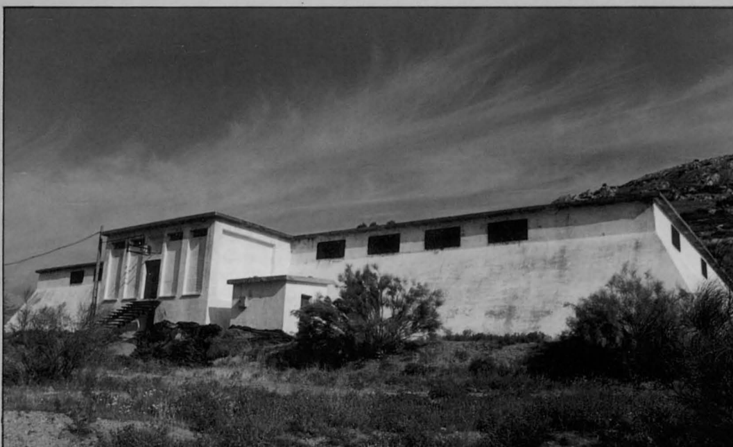
El depósito de agua, construido hace 25 años, padece fisuras y filtraciones
