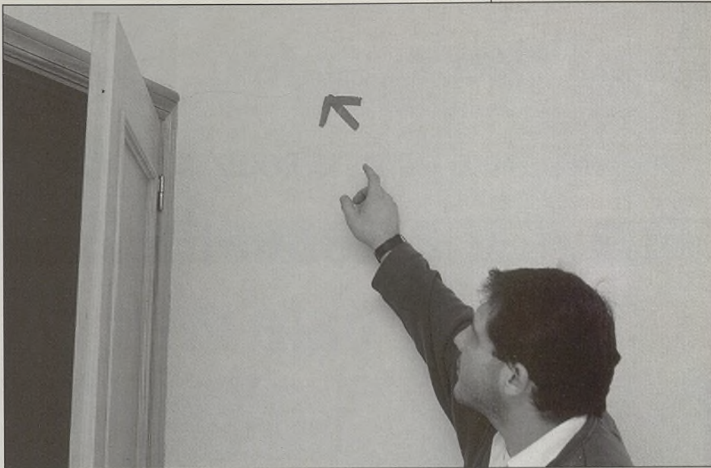
Eduardo Valle, uno de los afectados, señala algunas de las grietas que han aparecido en su vivienda.
