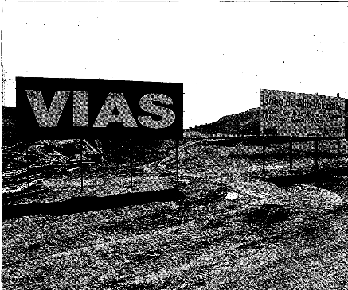
Hace meses que comenzaron a su paso por Cuenca las obras del AVE Madrid-Comunidad Valenciana./LA TRIBUNA
