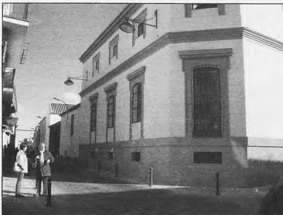
Se han finalizado las obras de la fachada del Museo y de las calles adyacentes. Ahora se han iniciado en la calle Monescillo, con una aparatosa zanja en el centro del paseo.
