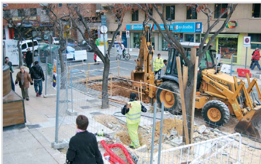
Arriba, obras para el soterramiento de los contenedores en la calle Carnicerías.
