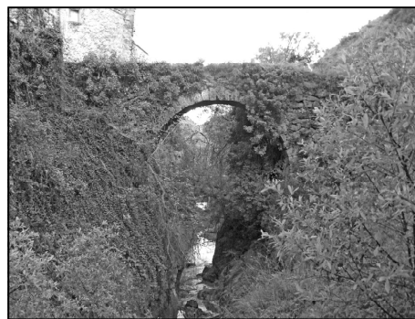
Alcantarilla de salida del agua del molino
