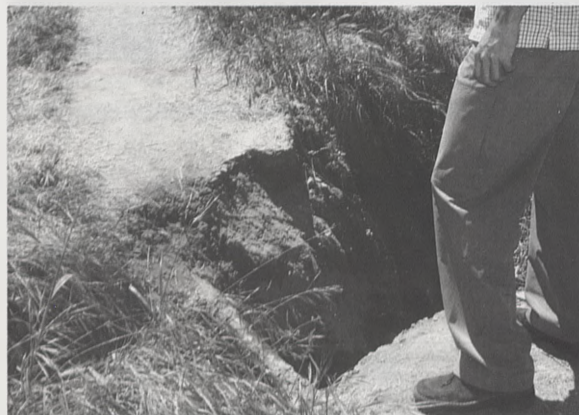
Peligroso socavón que impide el paso por la senda ecológica del Tajo junto al puente de San Martín.
